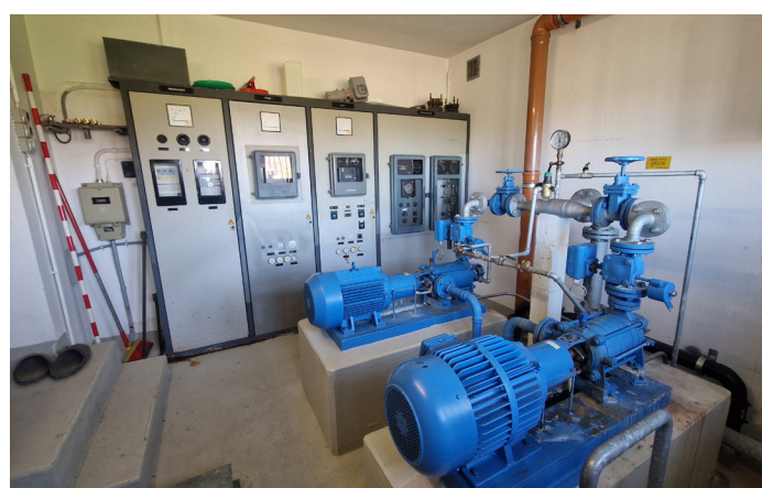
Im Innern des Pumpwerks.
