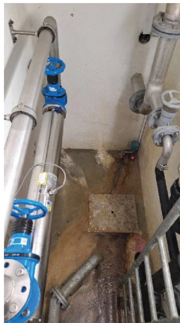
Bild 9: Rohrkeller auf Seite Zulauf Seelmatten
