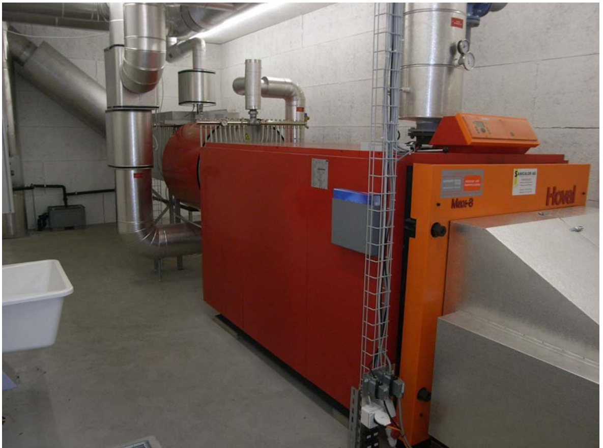
Neue 1250 kW Ölheizung Hoval Max-3 mit Powercondens in separatem Ölheizungsraum bei der Heizzentrale
